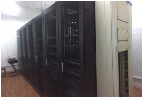
数据存储中心
